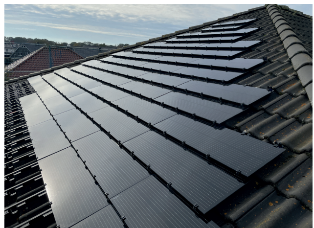
Das SOLo-System auf dem Dach
